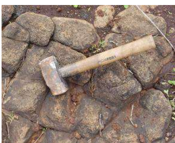
Figura 60 – Detalhe e afloramento de basalto com juntas abrindo caminho para alteração e separação da rocha em blocos.
