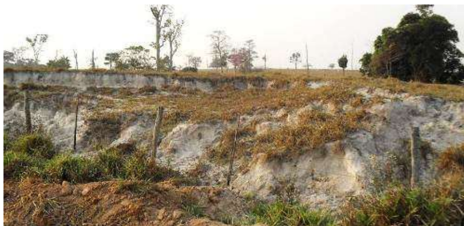
Figura 06 – Perfis de neossolo quartzarênico expostos por erosões, em região de pastagem, situada em vertente próxima a fundo de vale de colinas amplas.
