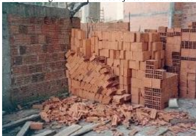
Figura 3 – Estocagem inadequada de tijolos em canteiro de obra.
