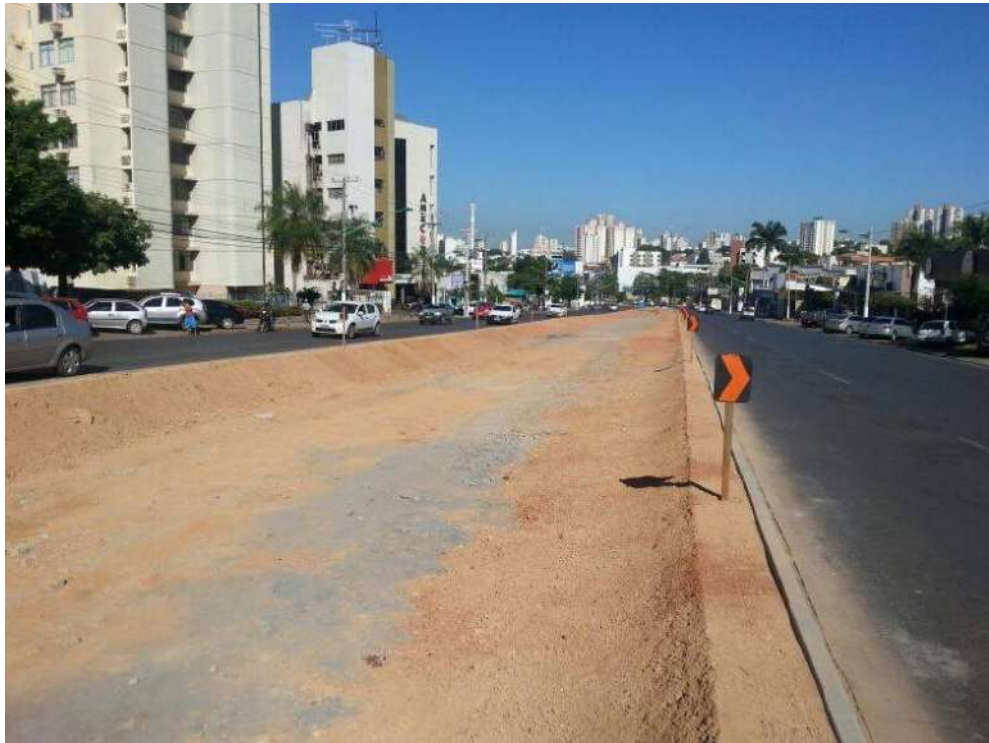
Figura 14 – Eixo 1 VLT em Cuiabá. Avenida Hist. Rubens de Mendonça próximo ao encontro com a Avenida Ten. Cel Duarte – Prainha. Estações do VLT – Bosque da Saúde, do CREA-MT e da Av. Mato Grosso.
