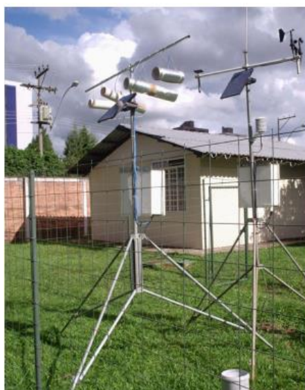
Figura 8 – Abrigo horizontal para medições fixo - instalados Fonte: Oliveira A (2007)
