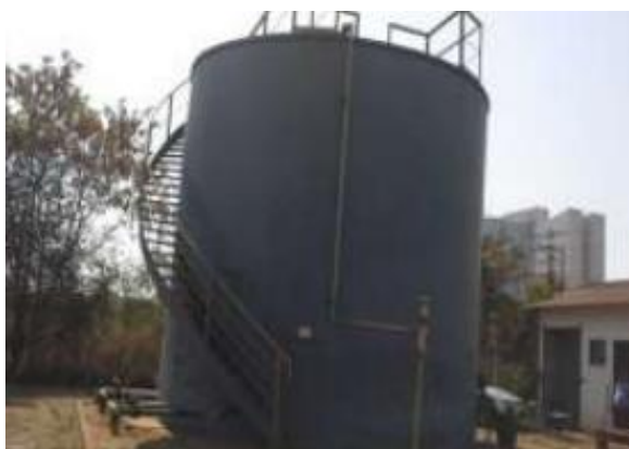
Figura 15: Reator UASB na ETE de Várzea Grande-MT Fonte: Santos (2018)
