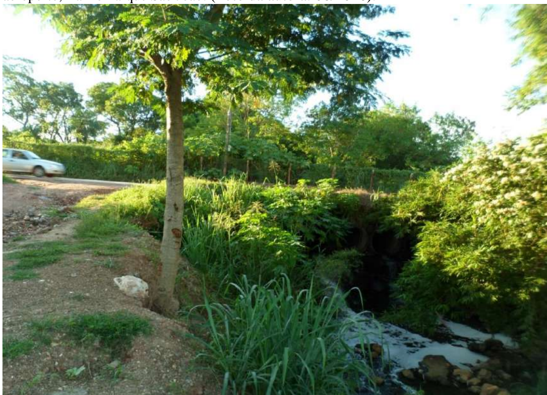
Figura 24- Erosão a margem do Córrego Jacaré no local a jusante da área verde do aeroporto, Bairro Parque São João. (Foto da autora. 06/2016).
