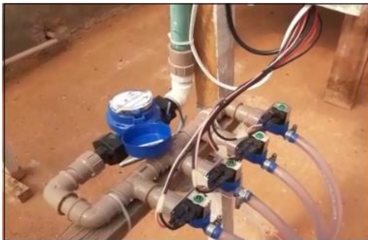
Figura 23. Hidrômetro instalado junto ao sistema de irrigação para registro do volume de água utilizado no ciclo do meloeiro.
