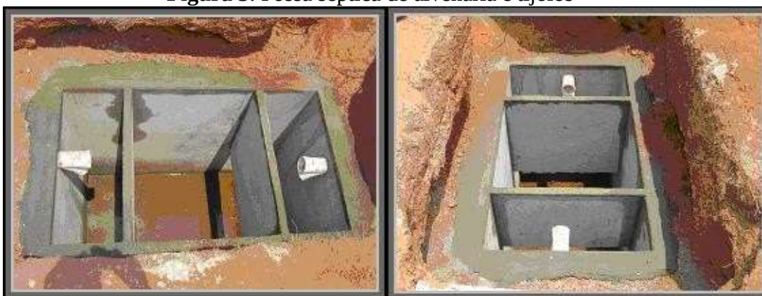
Figura 3: Fossa séptica de alvenaria e tijolos
